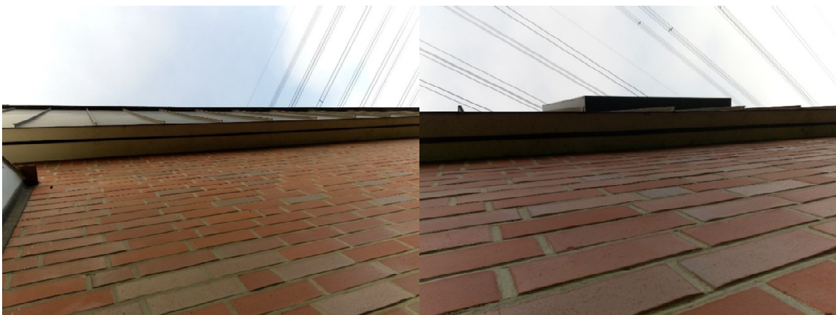
Abb. 9 und 10: Um das gesamte Gebäude herum besteht in den Spalten unter der braunen Fassadenverkleidung Quartierpotenzial in Form von Spaltenquartieren für Fledermausarten.
