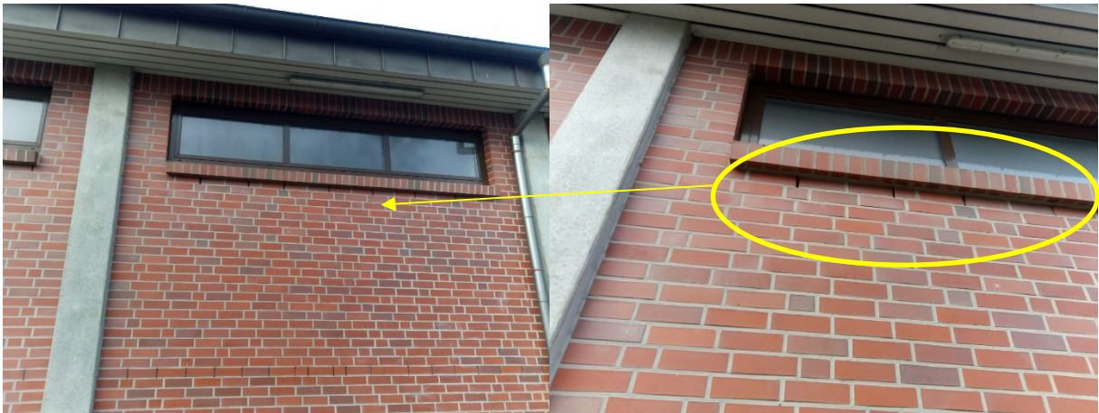
Abb. 8 a und b: Unter den oberen Fenstern befinden sich einige senkrechte Mauerspalt, die potenziell für kleine Fledermausarten als Zwischenquartier geeignet sind.
