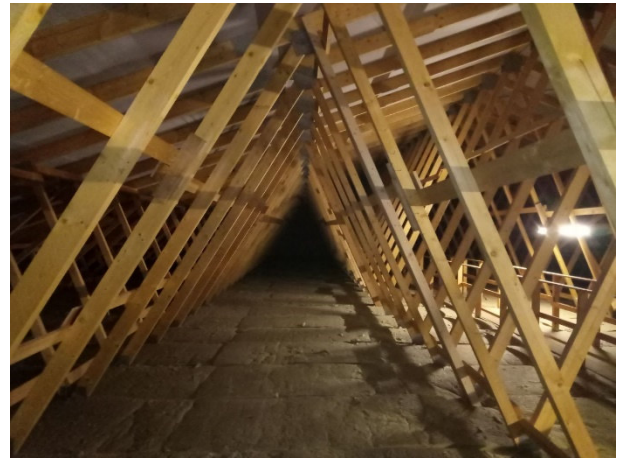
Abb. 2: Bis auf den begehbaren Holzsteg ist der Dachboden mit Holzwolle ausgelegt und nicht begehbar.
