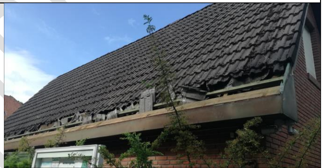
Foto 7: leeres Gebäude mit Schäden am Dach
