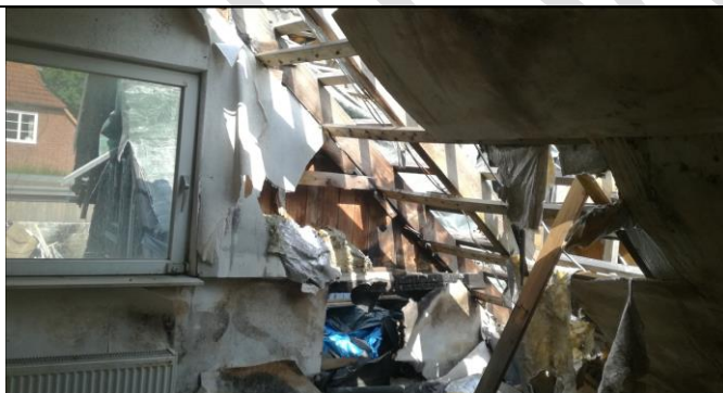
Foto 8: Innenräume tws. durchfeuchtet, tws. auch intakt und abgedichtet
