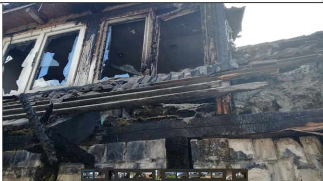
Foto 6: Brandschaden, Ritzen und Spalten jedoch mit Russ und Dämmwolle für Tiere nicht geeignet
