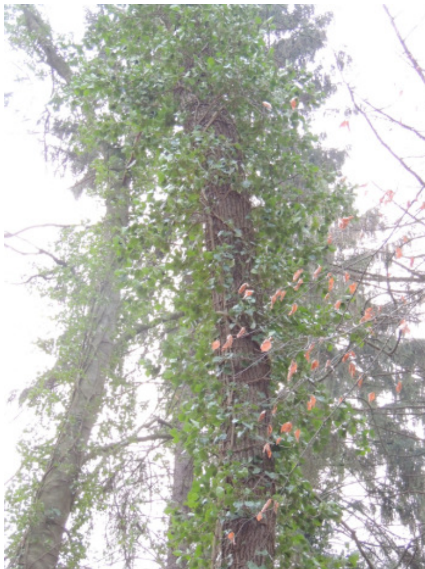
Abb. 7: Bei mehreren Bäumen ist aufgrund von stärkerem Efeubewuchs am Stamm bis in die Krone keine abschließende Bewertung möglich
