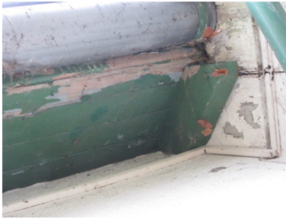
Foto 3: Haupthaus mit beginnenden Schäden an der Verschalung der Dachunterseite
