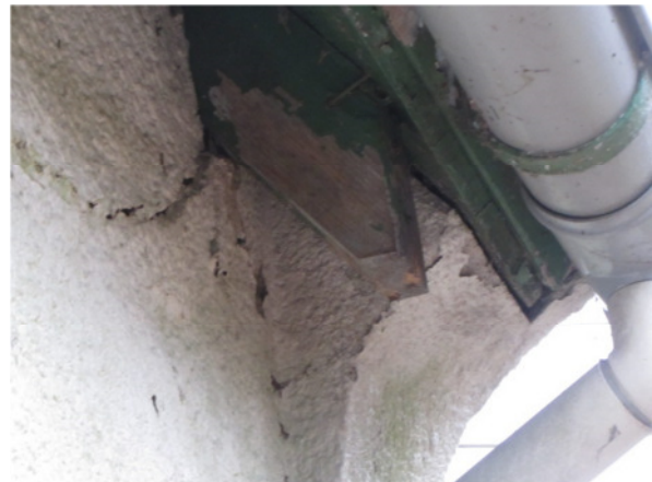
Foto 6: Garagengebäude mit beginnenden Schäden an der Verschalung der Dachunterseite
