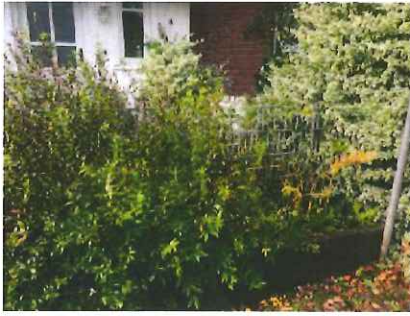
Betonsockel mit Doppelstabmatte
