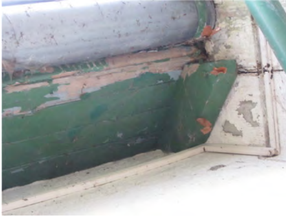
Foto 3: Haupthaus mit beginnenden Schäden an der Verschalung der Dachunterseite
